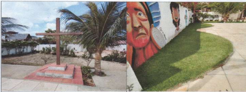
Cruz e alvenaria que será pintado Meio fios danificados que serão refeitos
